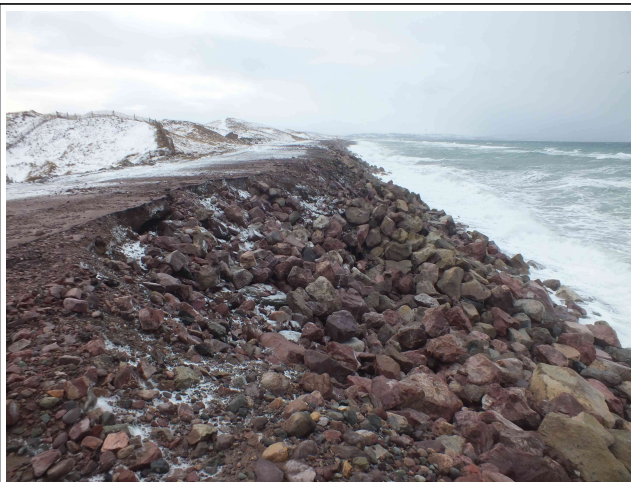
Glissement des enrochements dans l'effondrement amont le 6 mars
