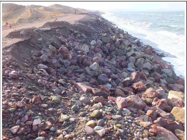
Glissement des enrochements dans l'effondrement amont le 22 mars
