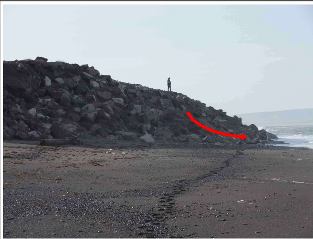
Glissement des enrochements Amont
